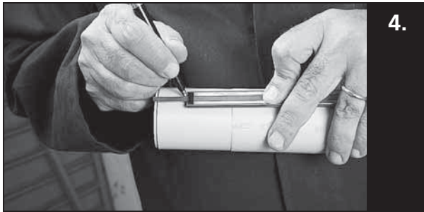
4. Geef op de leiding de insteekdiepte aan alvorens de las te maken. >> Zie onderstaande tabel voor de juiste insteekdieptes.
